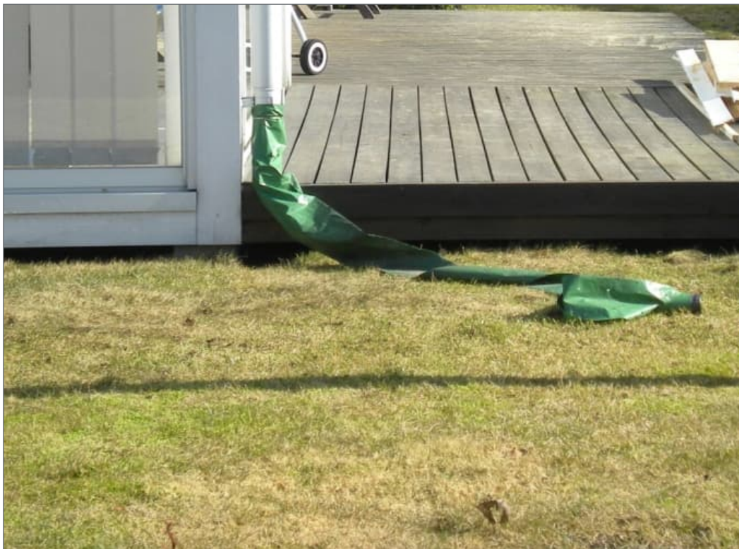
Figur 17. Stuprörsutkastare, exempel från Skrea strand.
